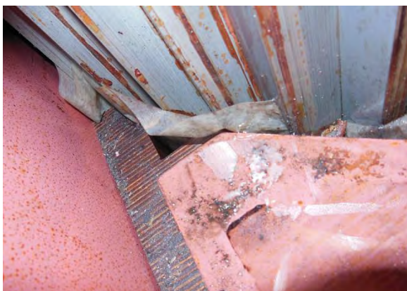
Рис. 1 - Низкое качество ремонта трансформатора: загрязнение поверхности отдельных узлов трансформатора вызвало частичные разряды порядка 1000 пКл, сработала газовая защита (фото авторов работы с места аварии)
